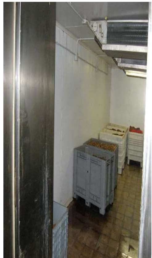
FOTOGRAFIA N° 108 Vano n° 7 – Cella frigorifera
