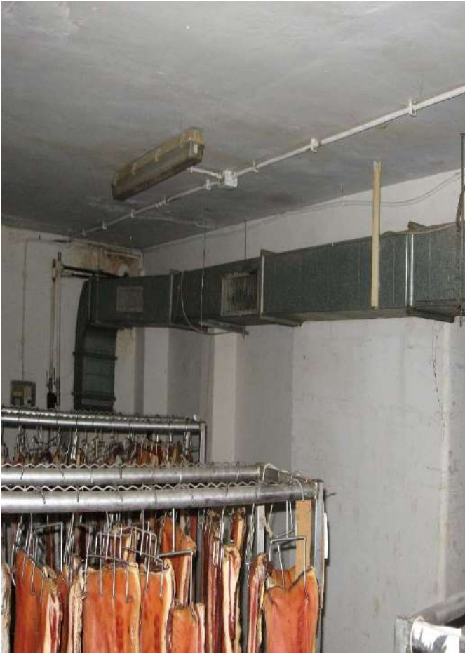
FOTOGRAFIA N° 77 Vano n° 14 – Loc. stagionatura ventilata
