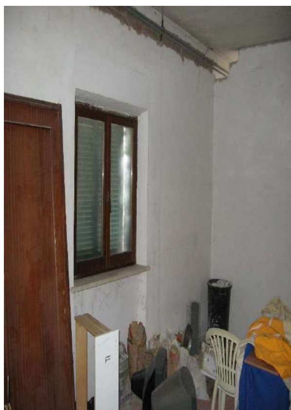
FOTOGRAFIA N° 52 Vano n° 29 – Loc. deposito
