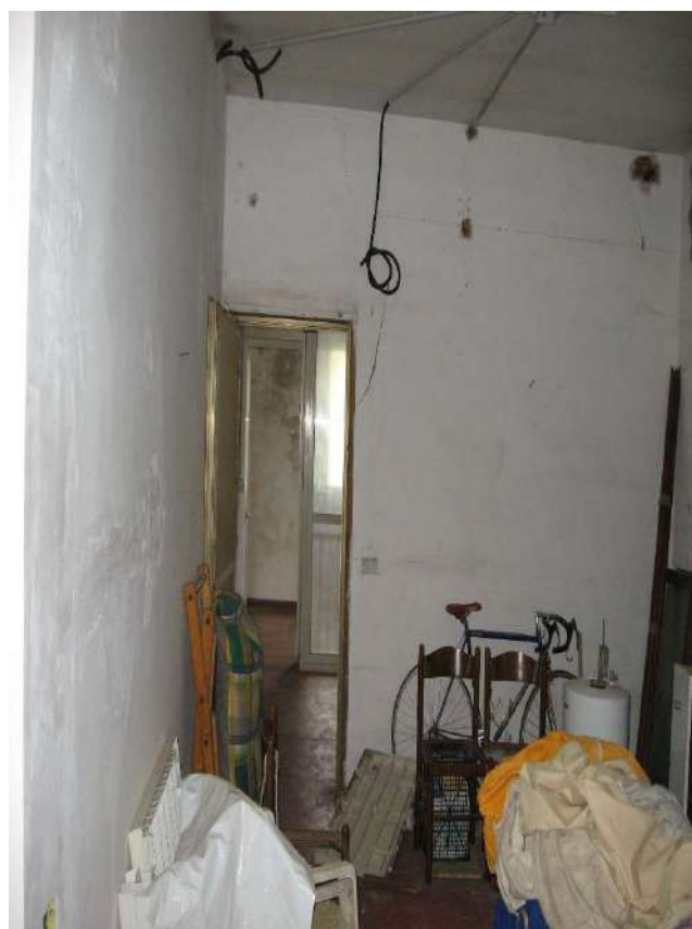
FOTOGRAFIA N° 54 Vano n° 29 – Loc. deposito
