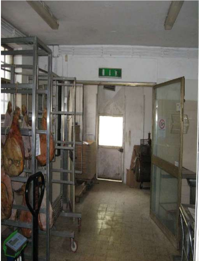
FOTOGRAFIA N° 89 Vano n° 12 – Loc. stuccatura
