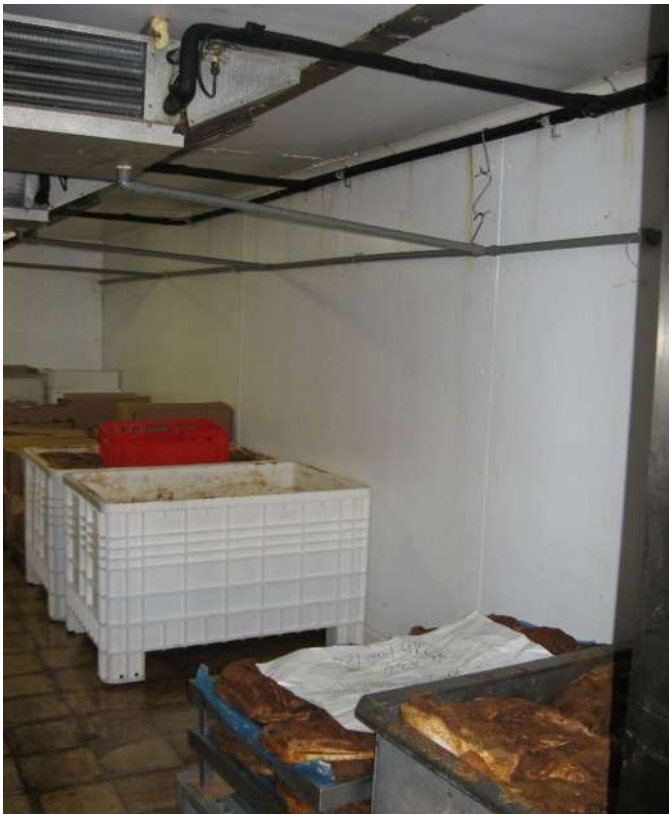
FOTOGRAFIA N° 109 Vano n° 7- cella frigorifera
