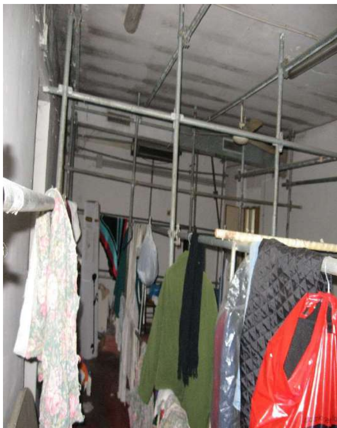
FOTOGRAFIA N° 49 Vano n° 27 – Loc. deposito
