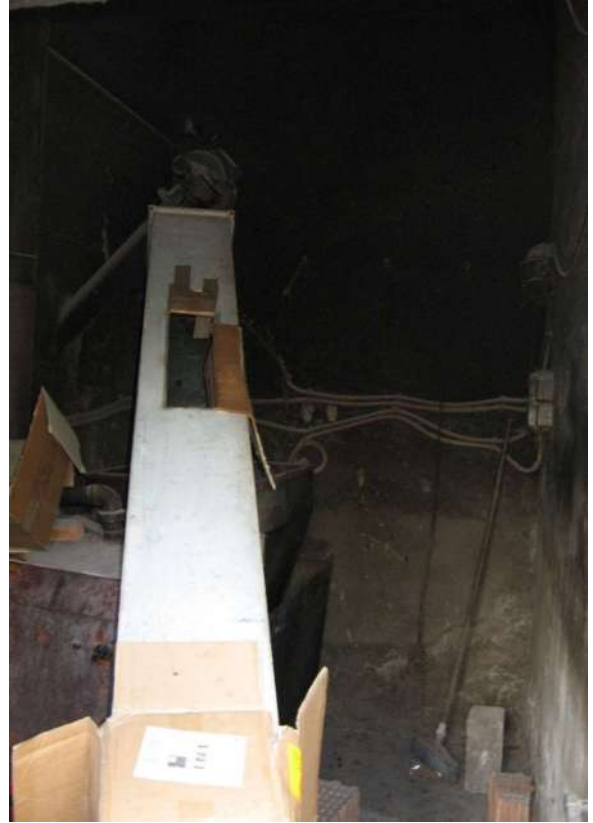
FOTOGRAFIA N° 122 Vano n° 25 – Centrale termica
