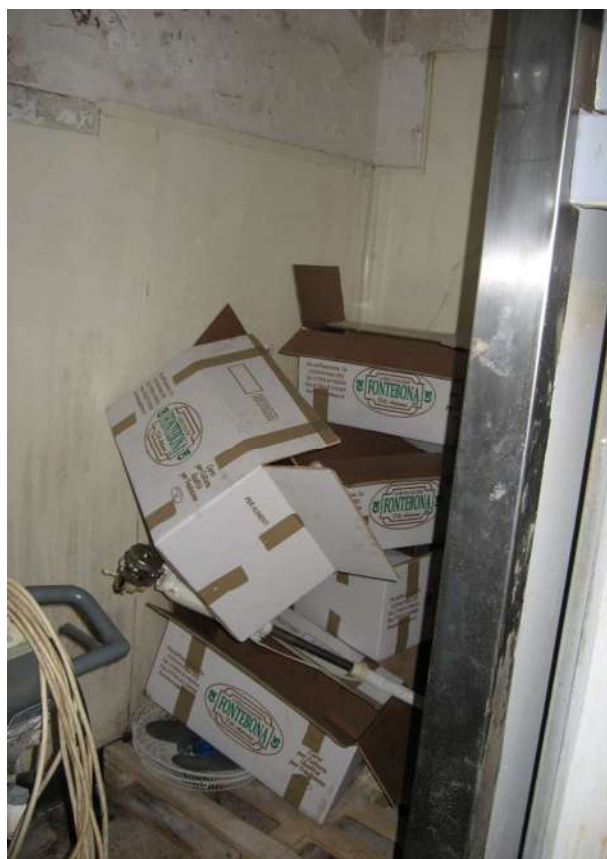
FOTOGRAFIA N° 102 Vano n° 9 – Loc. deposito
