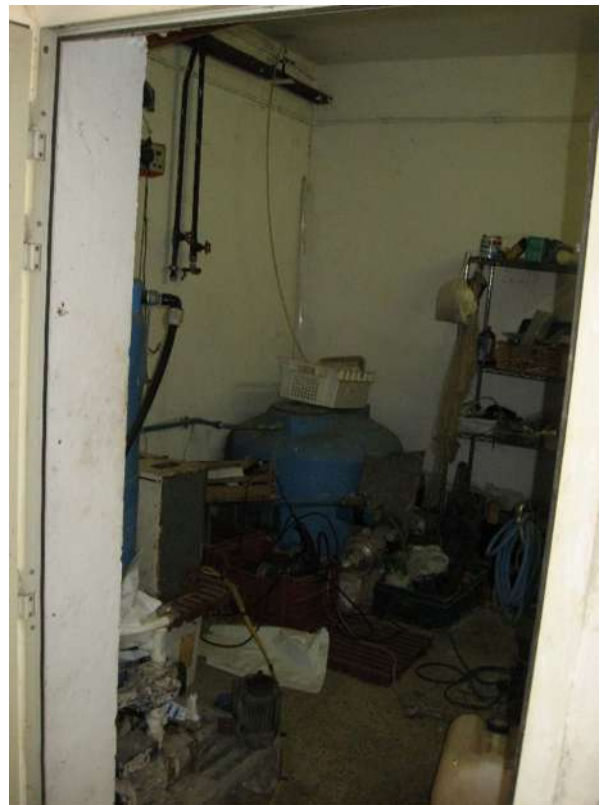
FOTOGRAFIA N° 118 Vano n° 2 – Cella frigorifera
