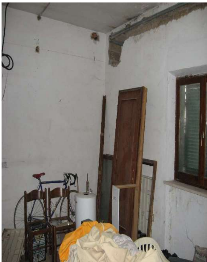
FOTOGRAFIA N° 53 Vano n° 29 – Loc. deposito
